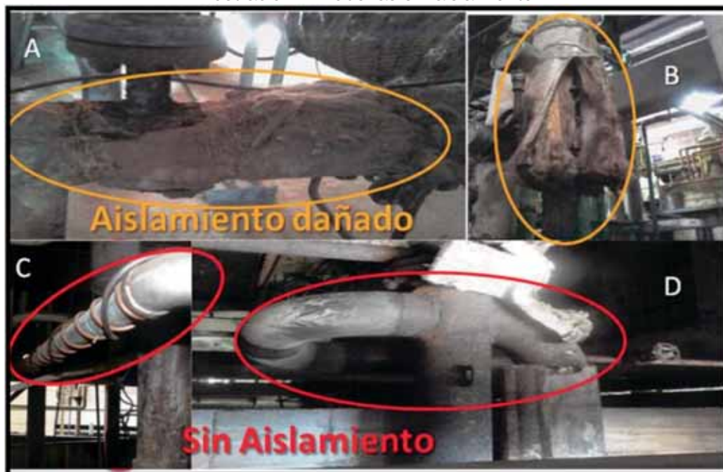
Ilustración 4. Tuberías sin aislamiento
