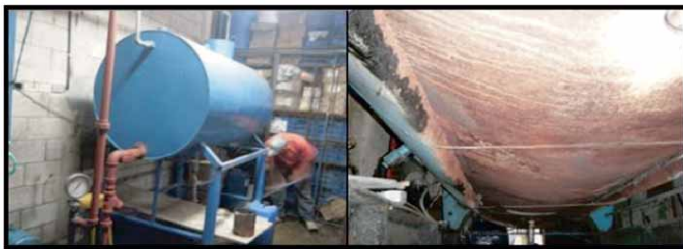
Ilustración 6. Tanques y superficies calientes sin aislamiento térmico
