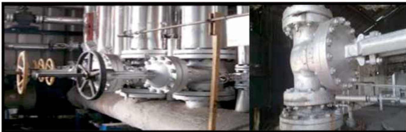
Ilustración 9. Válvulas sin aislamiento térmico
