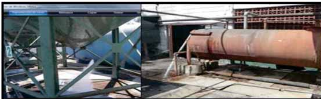
Ilustración 14. Punto donde se desecha el condensado.
