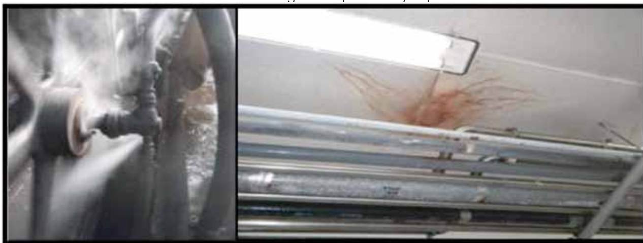
Ilustración 13. Fuga de vapor flash y vapor vivo
