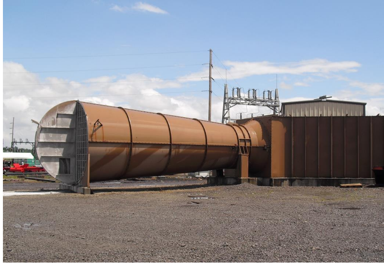
Figura 1. Ventilador Primario de 1125 kW Instalado como Extractor de Aire.
