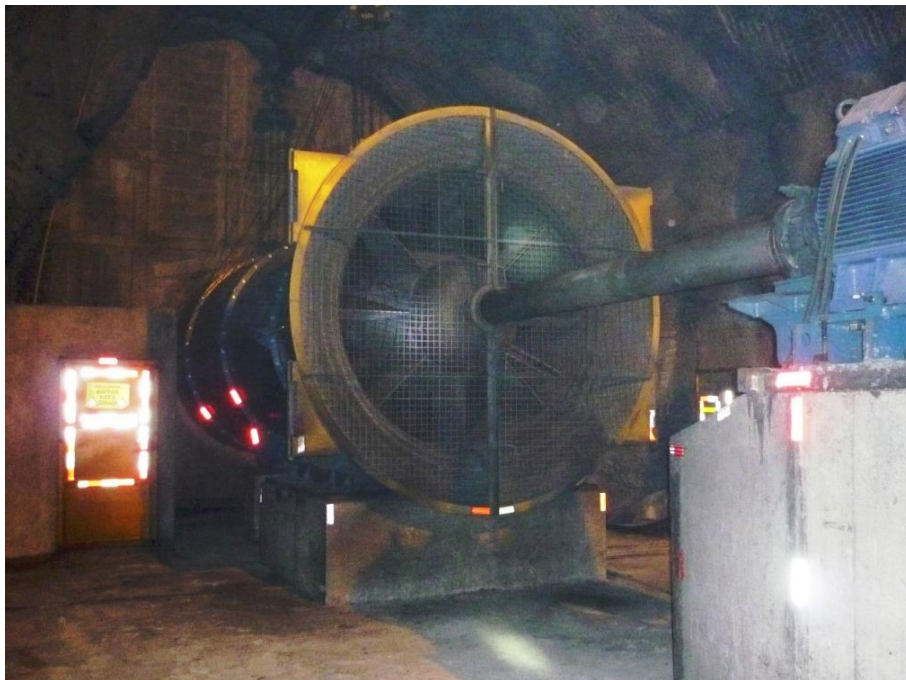
Figura 2. Ventilador Secundario en Muro de Concreto (Lado de Entrada).
